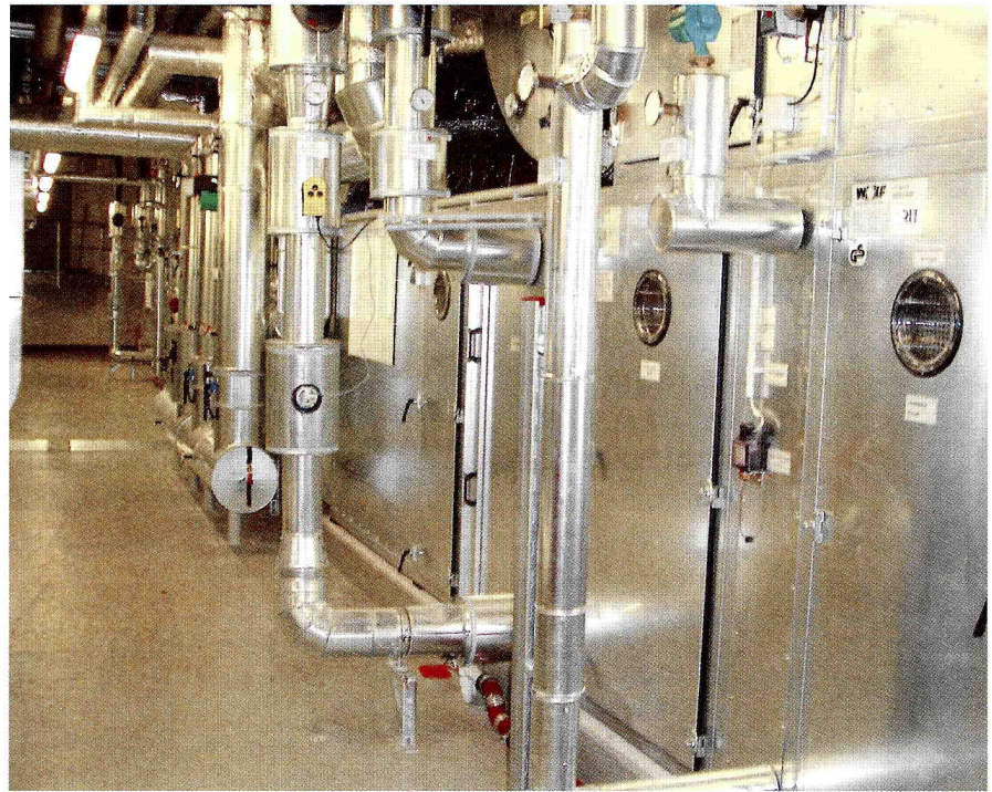
Blick in die moderne und leistungstarke Lüftungs zentrale der Allianz Arena.
