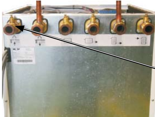
Handentlüfter im Sole-Eintritt
